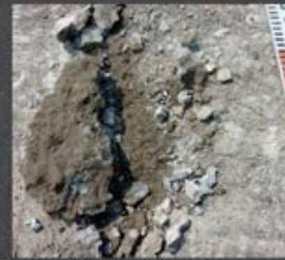
砂利化したRC床版コンクリート(アスファルト層除去) 森高真・久我隆一郎・小川聖一・久保源司 寒冷地で利用されたRC床版の劣化要因調査 コンクリート工学論文集 第74巻 第1号 2013年1月
