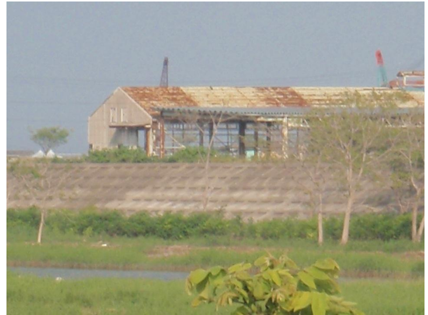
壁が壊れた工場
